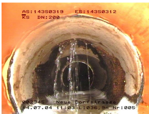
Grundwassereintritt in den Kanal
